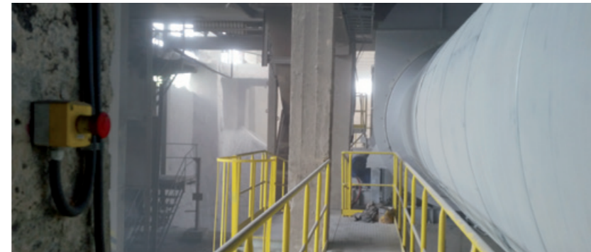
Trocken-Kühl-Trommel in Betrieb
