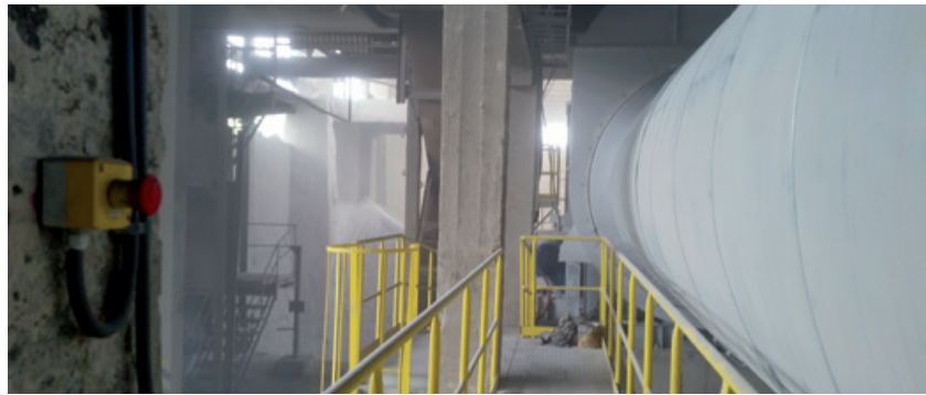
Trocken-Kühl-Trommel in Betrieb
