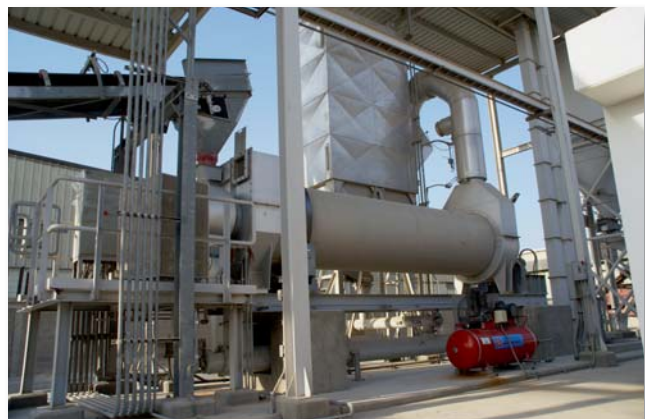
Figure 1: A typical rotary dryer plant for drying and cooling quartz sand Bild 1: Das typische Bild einer Drehrohtrockner-Anlage zur Trocknung und Kühlung von Quarzsand
