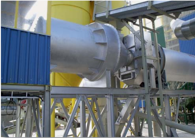
Figure 2: Combustion chamber on a rotary dryer – MOZER® system Bild 2: Brennkammer an einem Drehrohrtrockner, System MOZER®
