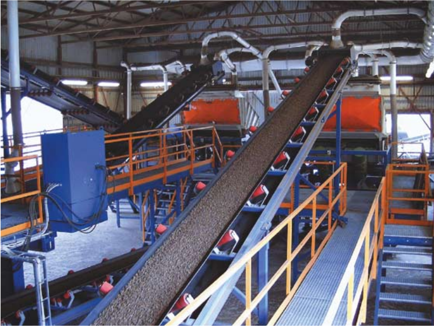
Siebanlage in der Kiesgewinnung
