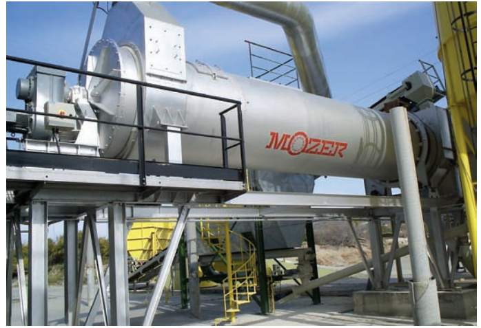
Trommeltrockneranlage „System Mozer“ zur Trocknung von Kalkstein und Diabas
