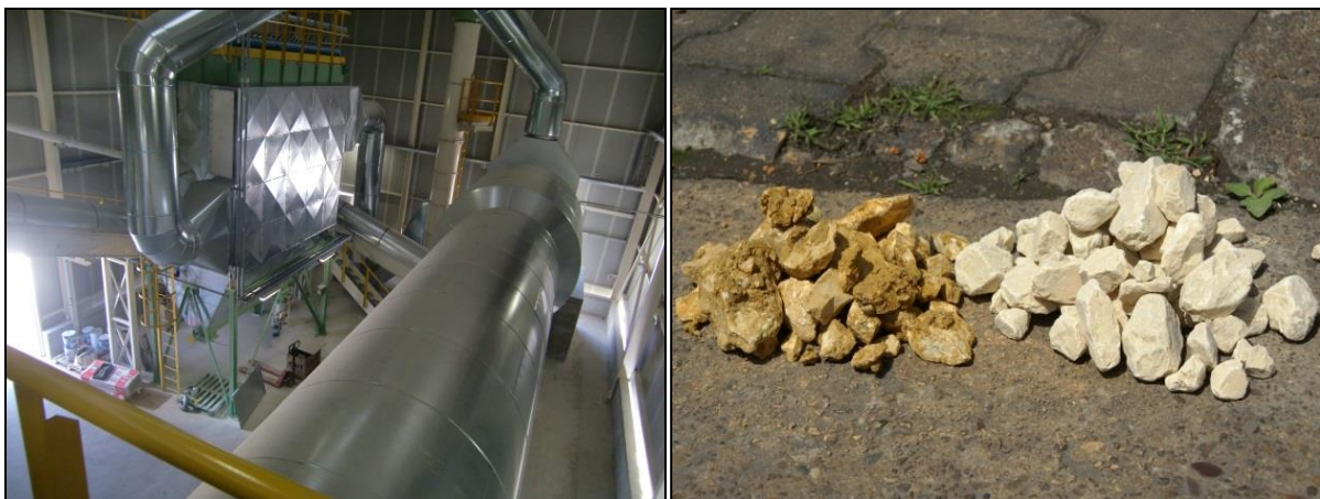
Abb. 2a und 2b: Trocknungsanlage für Kalkstein-Siebschutt und Produkte vorher/nachher
