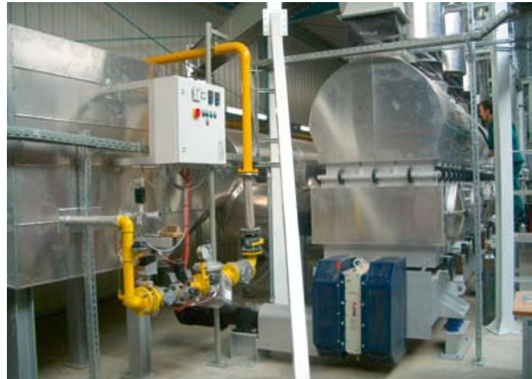
8 Fließbettrockner zur Trocknung von Kunststoffrecyclat mit Erdgas-Flächenbrenner als Heißlufterzeuger Fluidized bed for drying plastic recycle with natural gas surface burners as hot air generators
