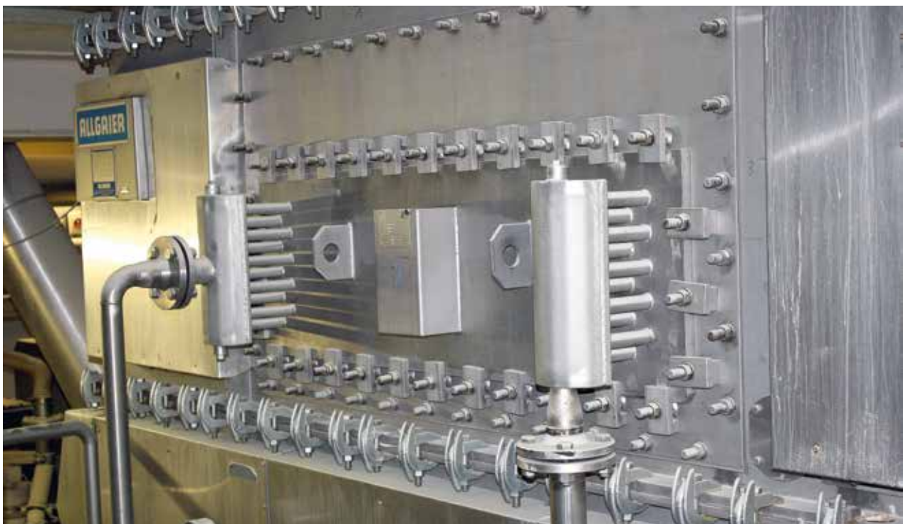
Transformateur intégré de chaleur à faisceau tubulaire à sécheurs à lit fluidisé
