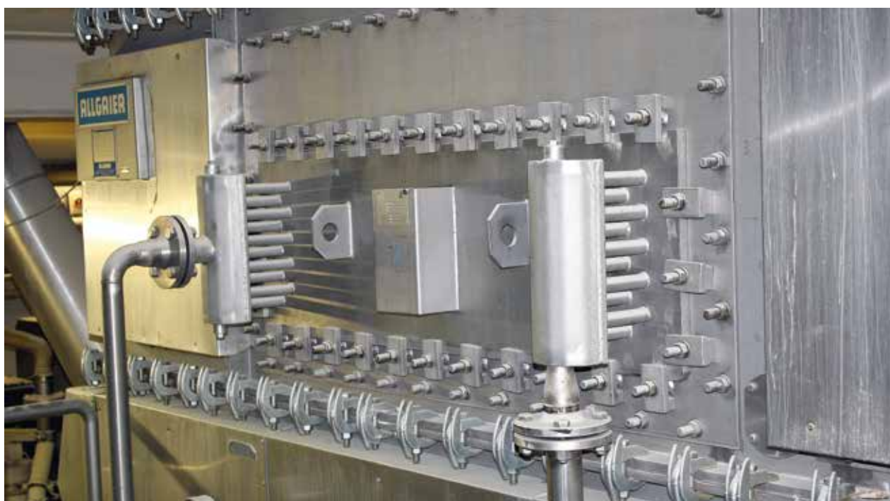
Встроенный трубный теплообменник в сушилке с псевдоожиженным слоем
