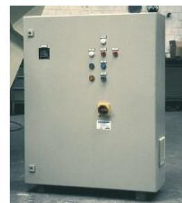
Электрощкаф с преобразователем частоты и устройством интервальной чистки
